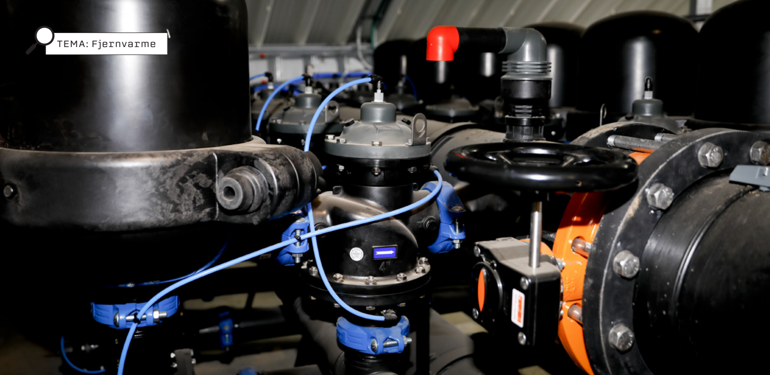
Filteranlæg for filtrering af urenheder i spildevandet før vandet ledes i varmevekslerne. Filteret filtrerer ned til 200 µm og kan om nødvendigt filtrere endnu finere. Filteret er selvrensende og behøver minimalt vedligehold.
